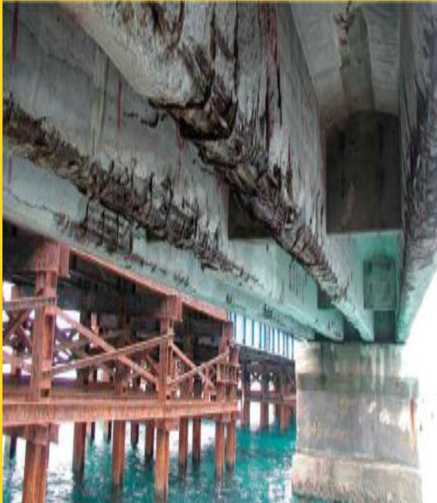
橋梁の老朽化
