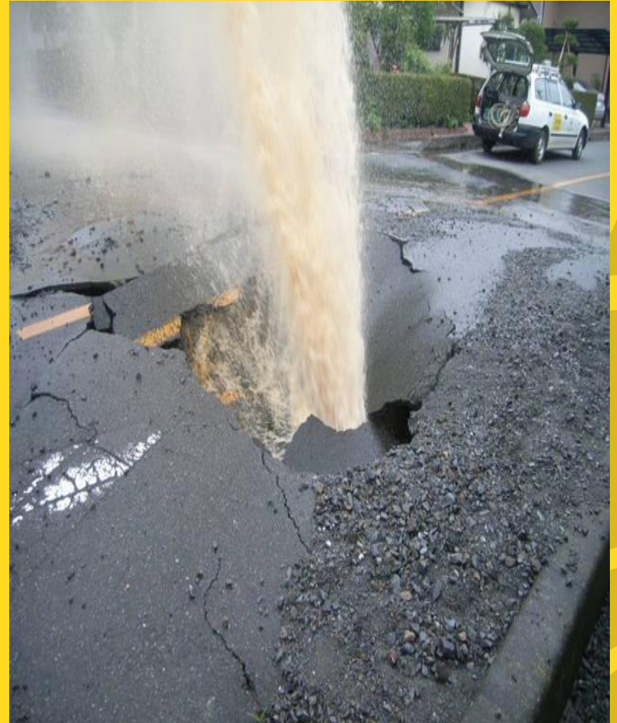
水道管の老朽化
