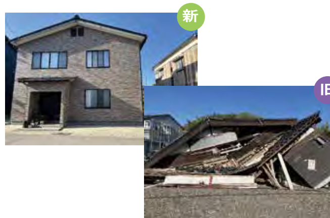
1981年以前に建てられたと思われる建物 無被害だった住宅と倒壊した住宅（輪島市）
