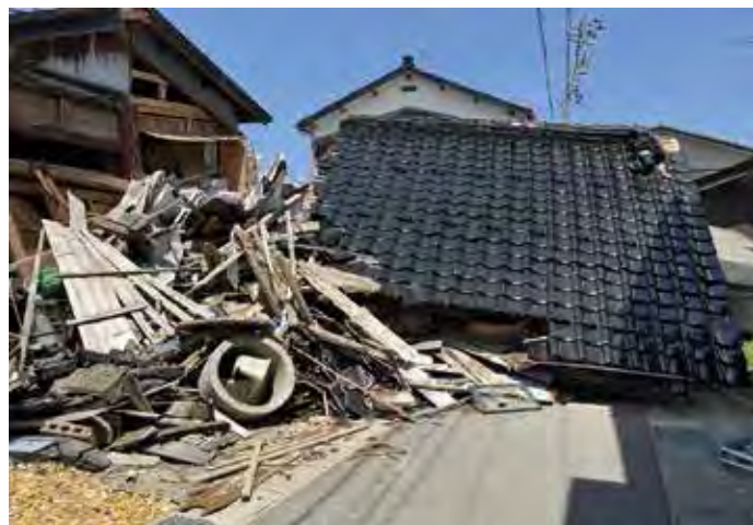
■ 全壊した住宅（珠洲市）
