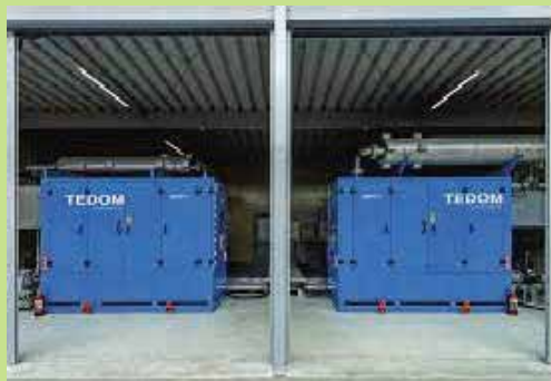
■ ガスエンジン発電機
